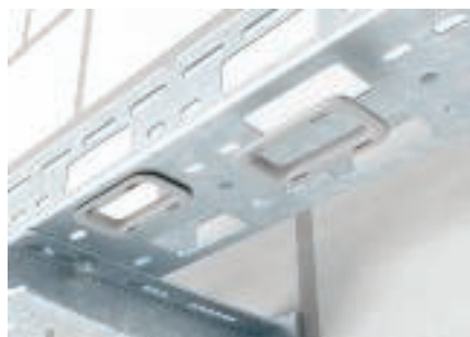
Inel de protecție a cablului la podea
