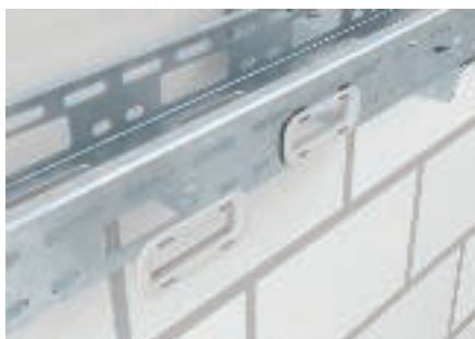
Inel de protecție a cablului la peretele lateral
