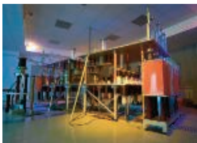
Gerador de corrente de raio
