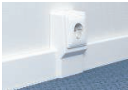
Montagem da tampa do suporte de aparelhos Suporte de aparelhos já montado.
