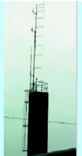
Figura 3: Torre emissora com equipamento de captação isolado e distância de proximidade definida
