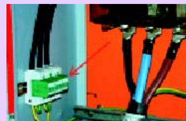
Figura 9: Utilização de descarregadores de sobretensões atmosféricas da classe B ou I para a alimentação do quadro principal
