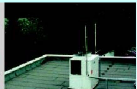
Figura 5: Unidade de frio isolada
