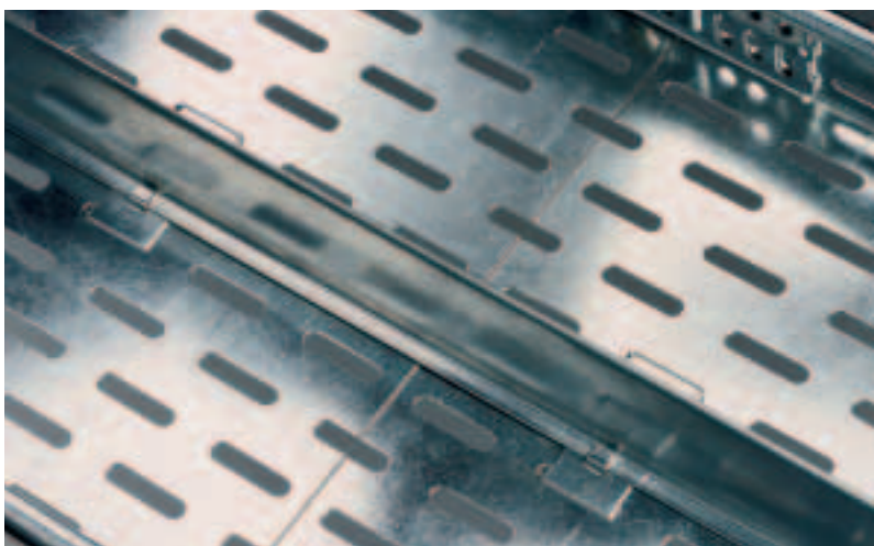
Gemonteerd scheidingsschot in een MKS-kabelgoot
