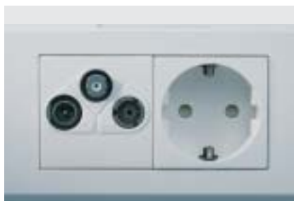
Antenne-aansluiting en Schuko-stopcontact
