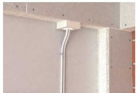
Bei Kabelbündeln und Einzelkabeln größeren Querschnitts werden hierzu zusätzlich Aufdopplungsstücke an der Kanalwand befestigt.
