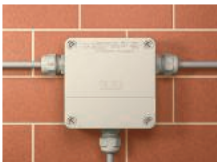
Montage terminé de la boîte de dérivation type B9T avec des presse-étoupes.
