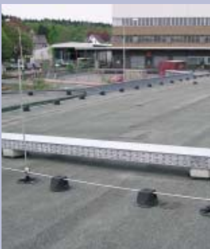
Schutz von Kabeltragssystemen
