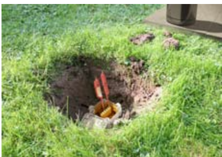
Bild 4: Prüfung eines vergossenen Kabelkastens
