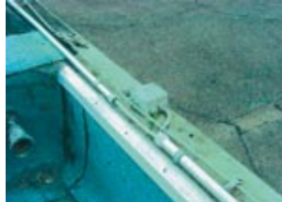
Bild 2: Teilblitzstromeingkopplung durch fehlerhafte Verlegung der Stromversorgung Klimagerät
